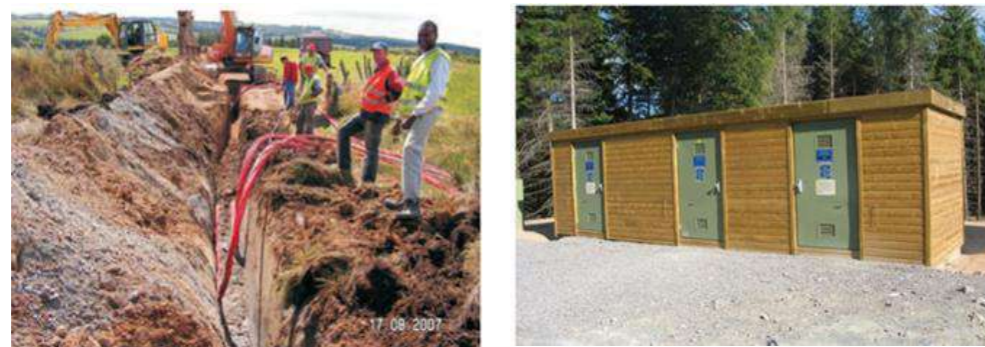
Figure 30 : Déroulage et pose des câbles (à gauche), exemple de poste de livraison (à droite) Source : EDF Renouvelables
